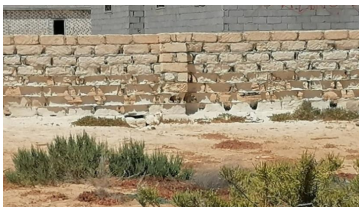
الشكل 12: تأكل احجار البناء نتيجة لهجوم الاملاح.
