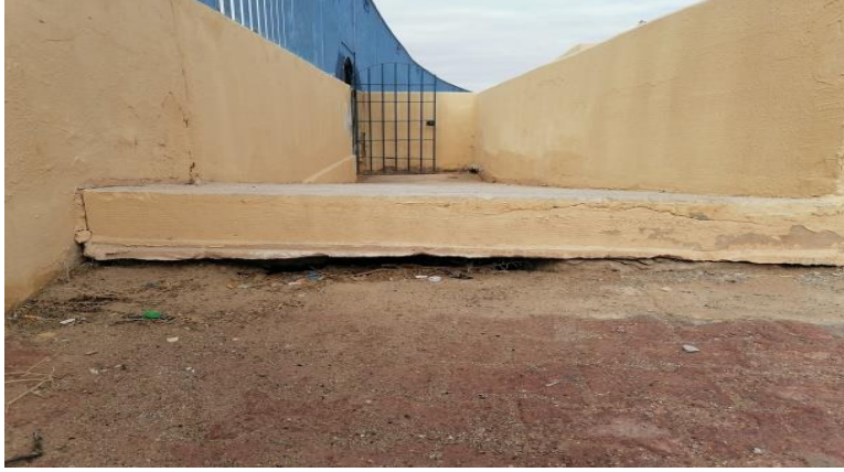
الشكل 5-ب: يوضح هبوط لأرضية أحد المباني في المدينة الرياضية
