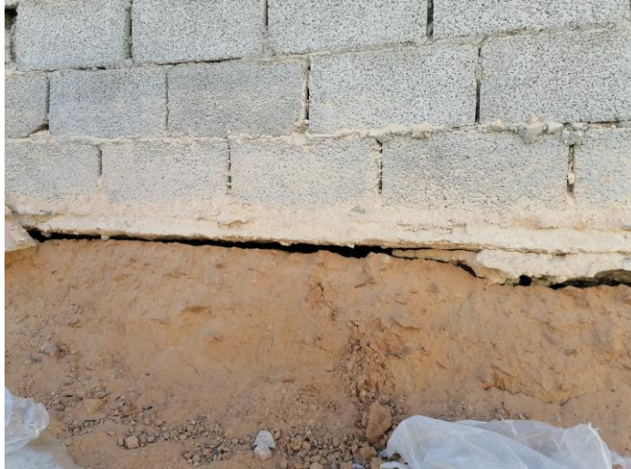
شكل 5-أ: يوضح هبوط لأرضية أحد المباني والتي تقع نهاية شارع طرابلس
