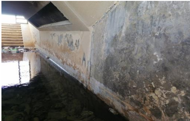
الشكل 6-أ: الفيضانات. نفق تحت الأرض
